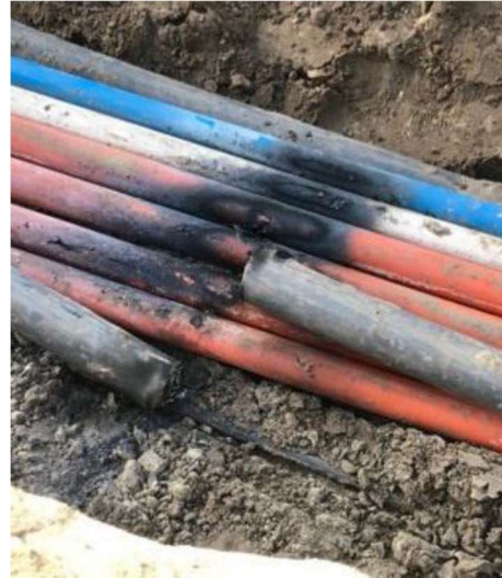
Foto: verkeerde kabel onder spanning geknipt
