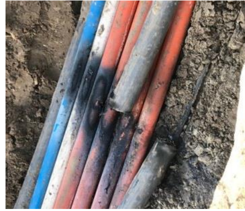
Foto: verkeerde kabel onder spanning geknipt
